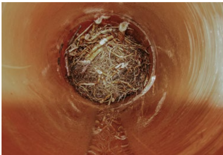
24. fotó: Gyökérbenövés a csatornában
