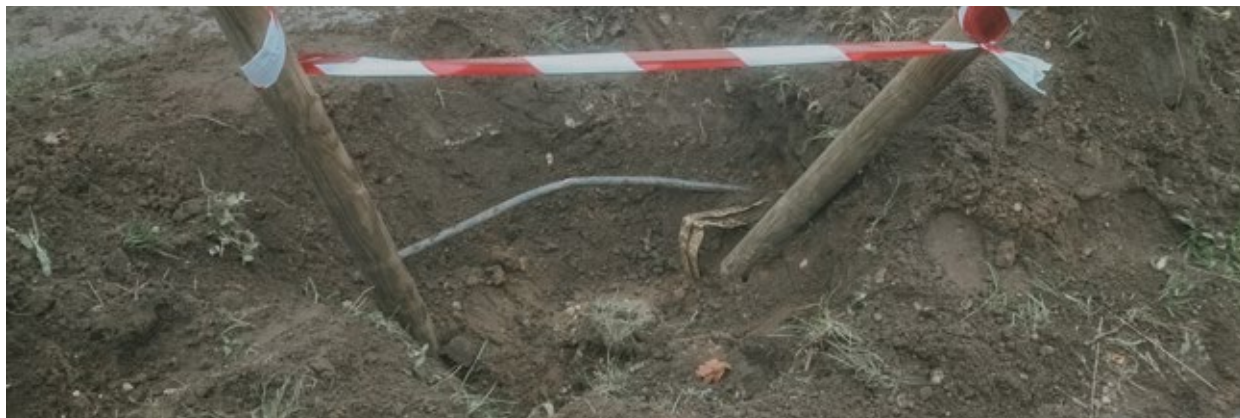
27. fotó: A közvilágítás kábel sérülése faültetése során
