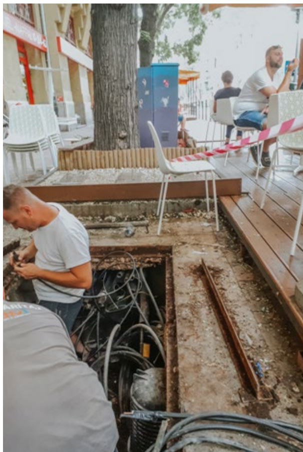
19. fotó: Fahely alatt áthaladó kábelcsatorna
