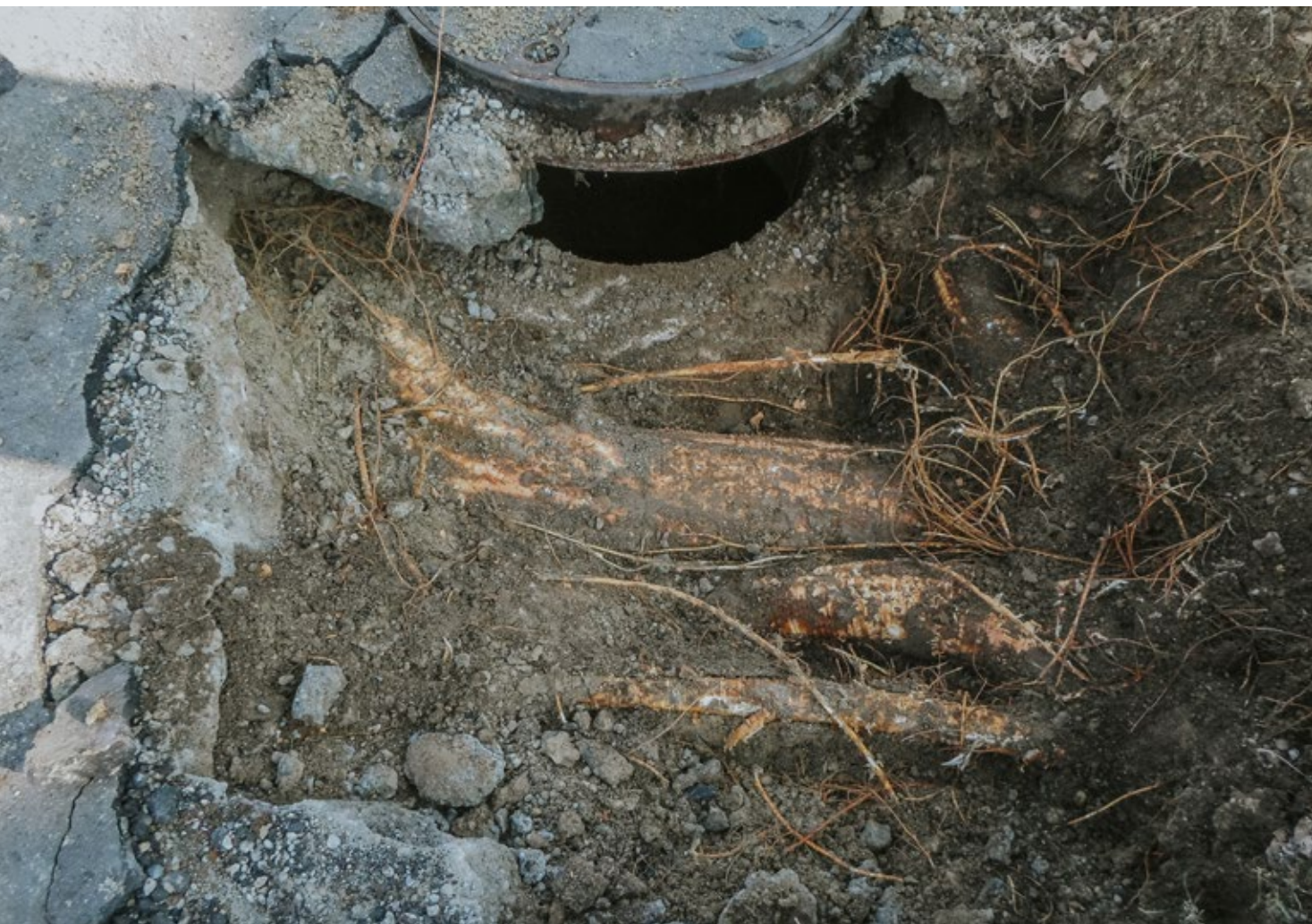
28. fotó: Gyökérbenövés a Telekom aknába
